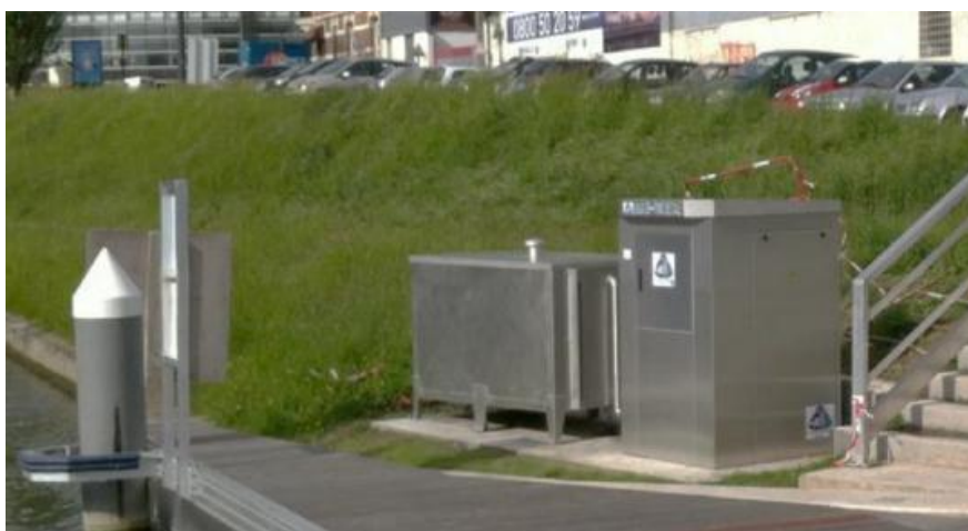
Photo n° 3 : Exemple de dispositif de pompage des eaux de fond de cale
