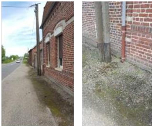
Photo n° 33 : Rejet EP de la maison (rue du Fort Gassion)
