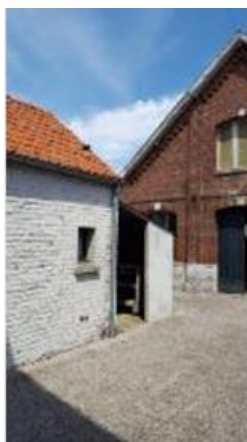
Photo n° 34 : Rejet EP de l'annexe enterré
