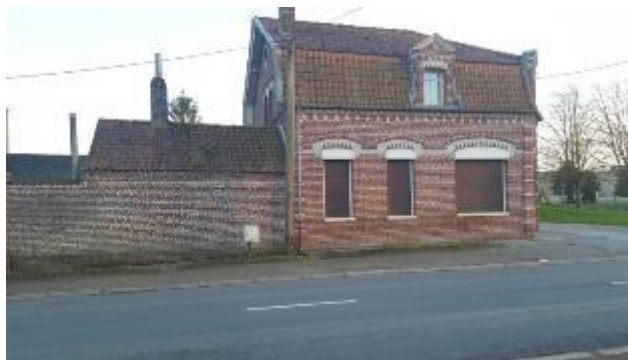
Photo n° 38 : Coffret gaz en façade (rue du Fort Gassion)
