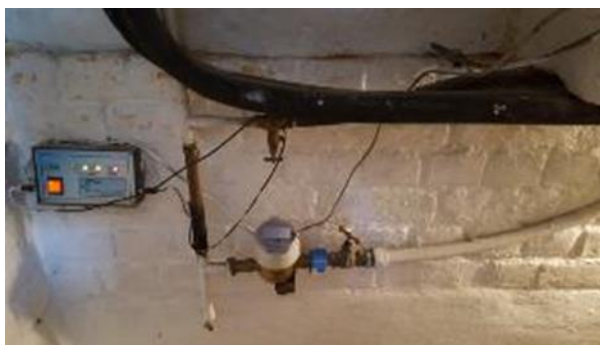
Photo n° 31 : Compteur d'eau dans la cave
